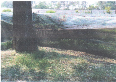
Imagen 9. Daños en infraestructura
