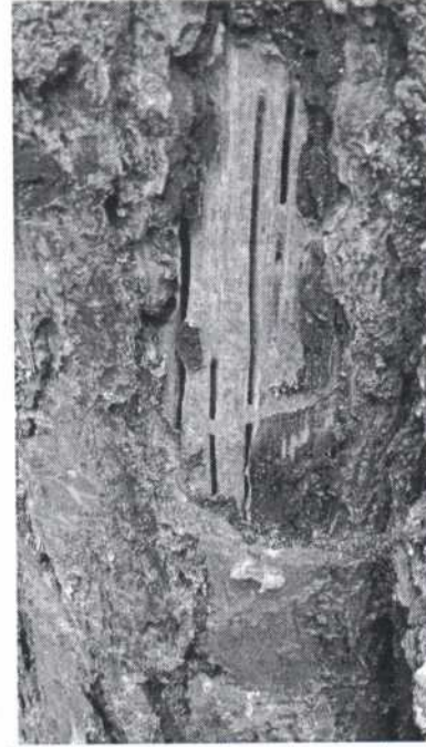
Figura 2. Galerías ocasionadas por las termitas.
