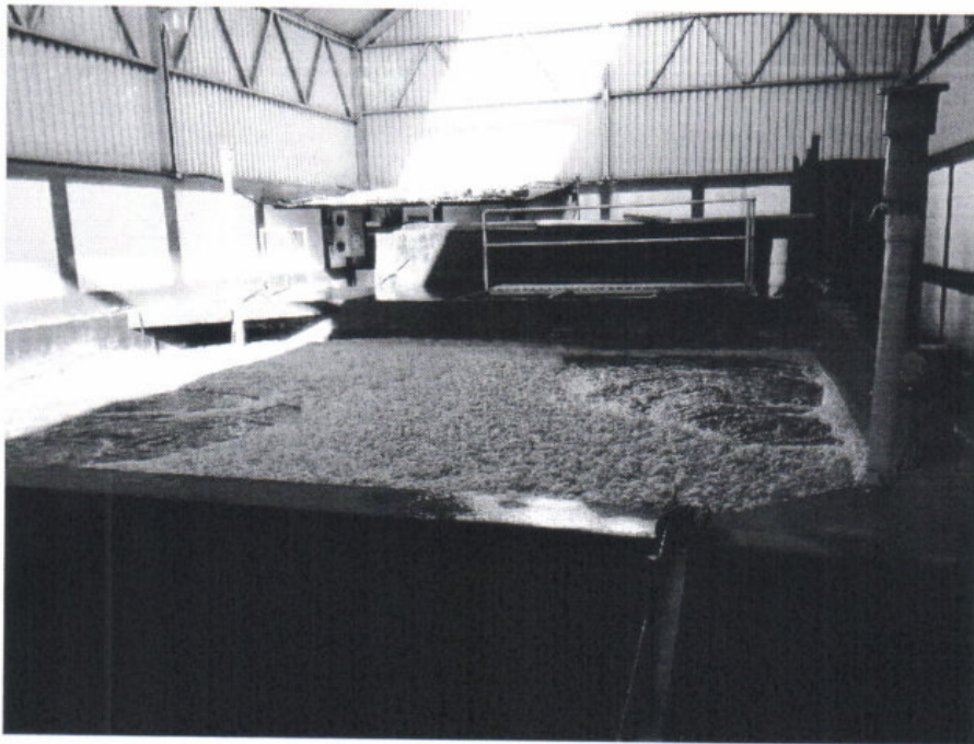
Fotografía 2. Planta de tratamiento ubicada en el Mercado municipal de Villa Nueva.
