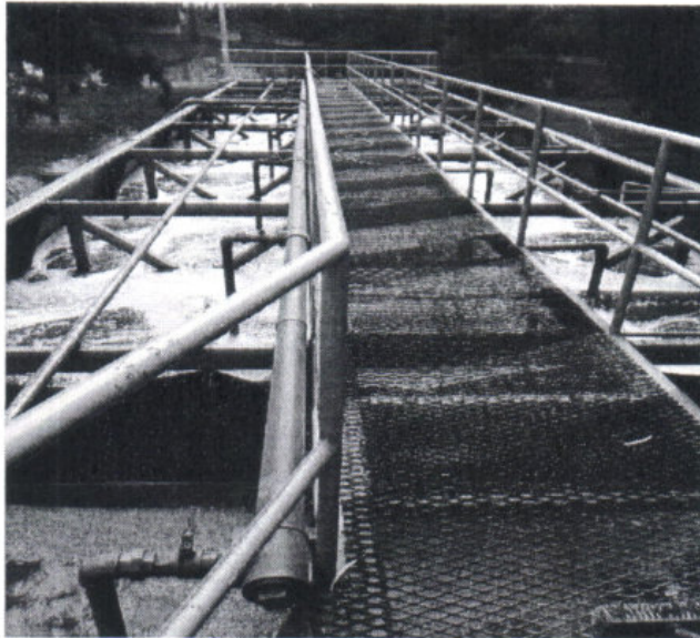
Fotografía 1. Reactor aerobio, planta de tratamiento municipal y ENCA.
