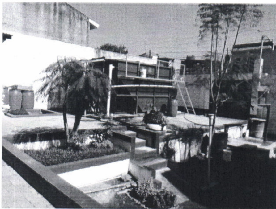
Fotografía 3. Planta de tratamiento de la colonia San Luis, Villa Nueva.
