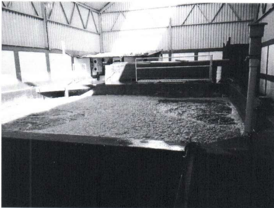
Fotografía 2. Planta de tratamiento ubicada en el Mercado municipal de Villa Nueva.
