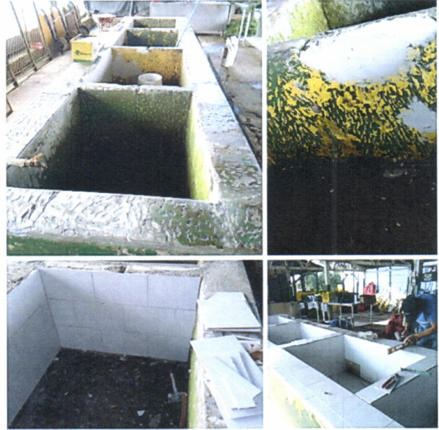
Figura 4. Modificación y arreglos de las pilas de lavado de hortalizas.
