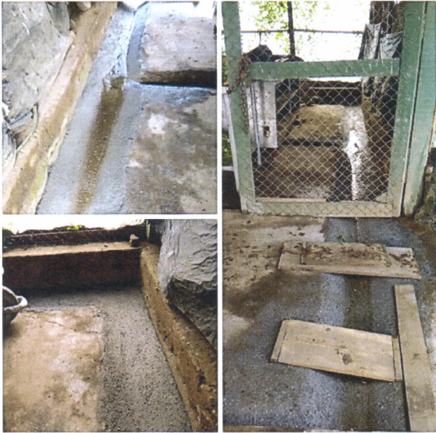
Figura 3. Modificación y arreglo de los canales de paso de agua que se encuentra dentro del área de empaque.
