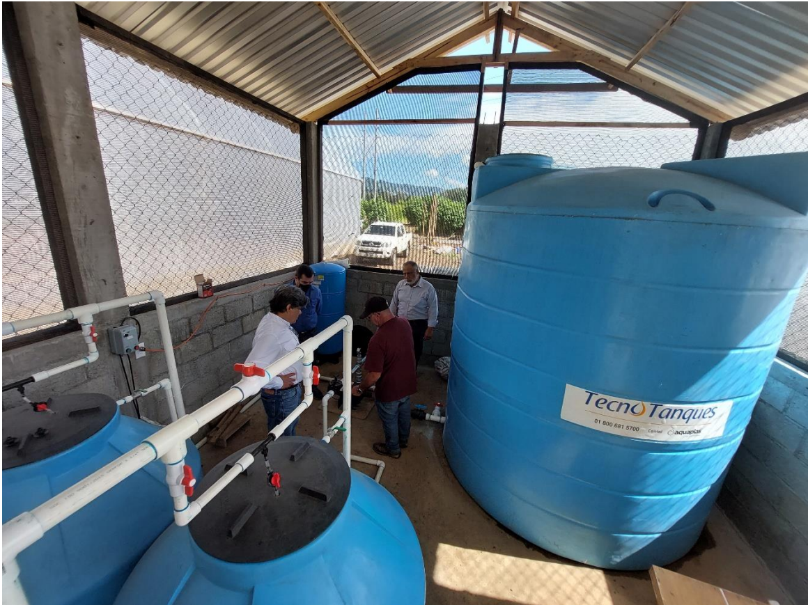
Fotografía: Sistema de Riego del Centro, con batería de Fertilización y Bombeo.
