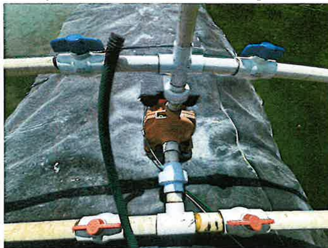
Figura 10. Cebado de bomba estanque 1-2.
